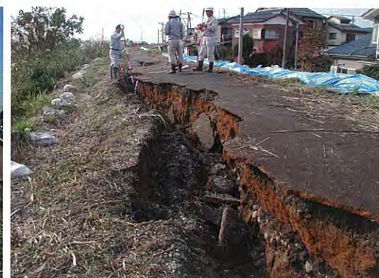
写真-3 崩壊した堤防と近接する家屋
