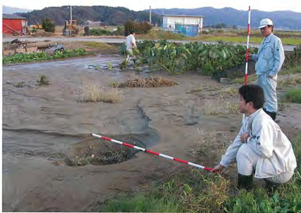
写真-4 堤防法尻付近の噴砂跡
