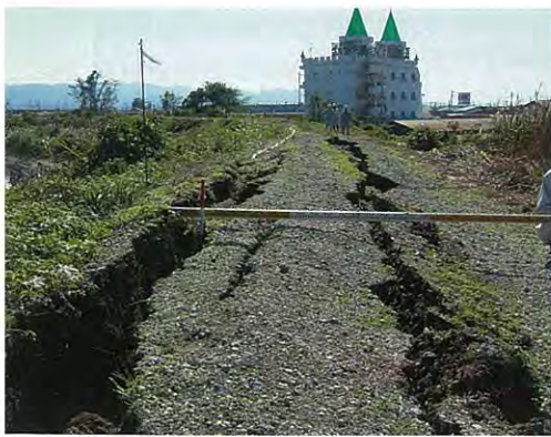
写真-1 堤防天端の亀裂 (左岸:見附市山吉町)
