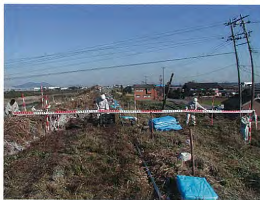
写真-2 堤防法面の側方流動 (右岸:見附市山吉町)
