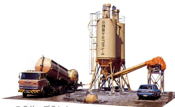
スラリープラント
